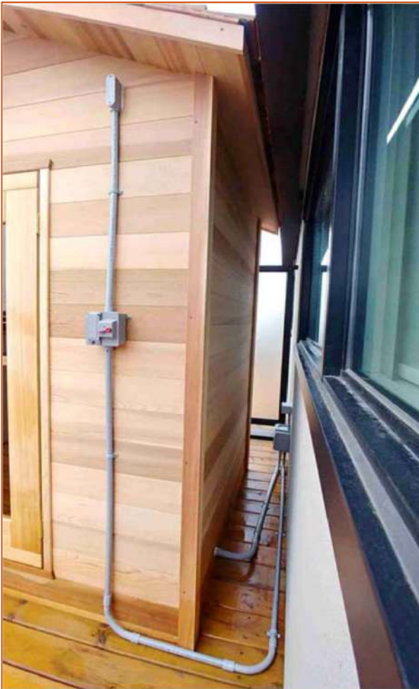
Weatherproof Conduit & Light Switch
